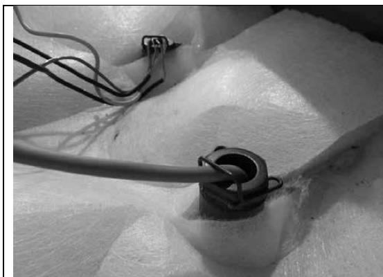
Fig. 15 – imaginea senzorului de temperatură apă TK în teaca cazanului; pentru cazanele tip DxxP, Pxx
